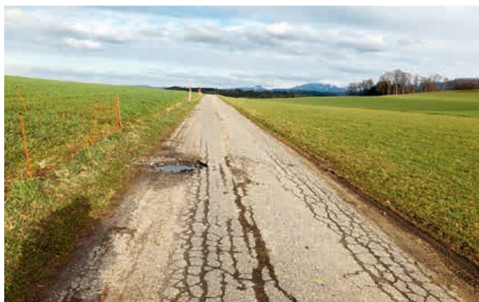
Route du Trimbié avant réfection
